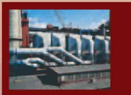
„Odprášení kotlů teplárny“ (závod 4 – Energetika)
