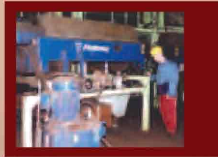
„Zařízení k odvodňování vysokopecních a ocelářenských kalů“ (závod 4 – Energetika)
