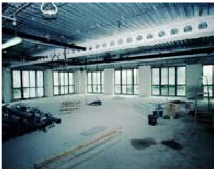
Figure 3 : Espace ouvert et flexible grâce aux grandes portées des poutres en acier
